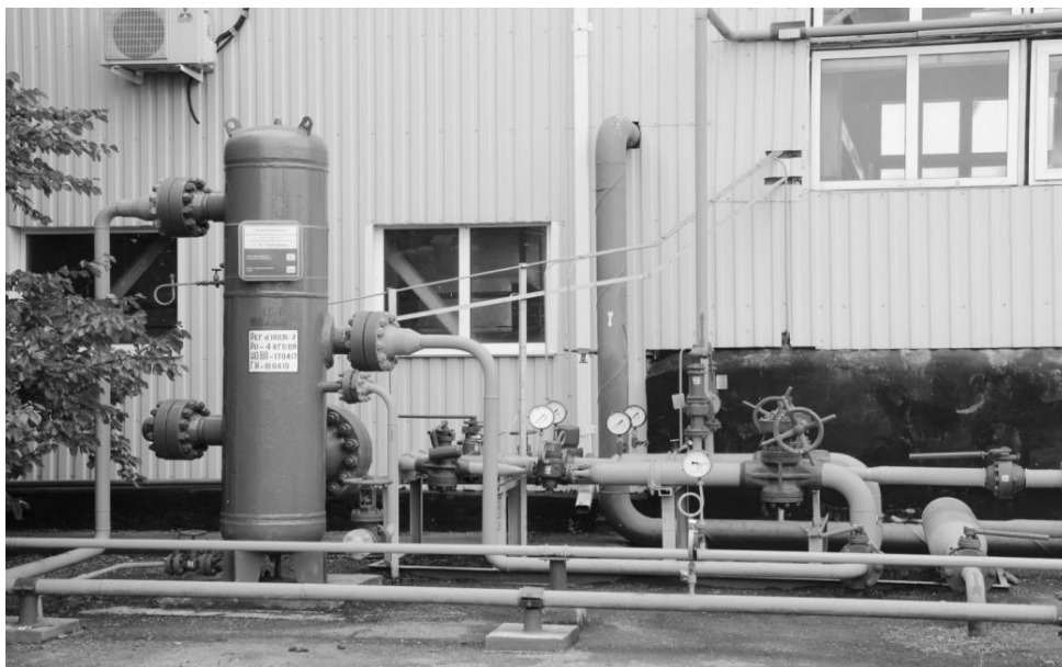
Рис. 2. Пункт редуцирования топливного газа компрессорных цехов
