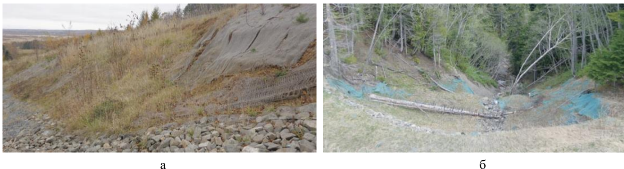
Рис. 2. Пример неэффективной работы кокомата и энкамата [5]: а – откос трассы нефтегазопровода с оползневыми сдвигами (несработавшие кокоматы, 4–5 лет после укладки); б – активный оползень на одном из участков трассы, способствующий накоплению материалов в русле селеопасной реки
